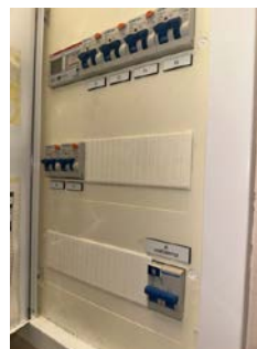
Sikringsskap med automatsikringer.
