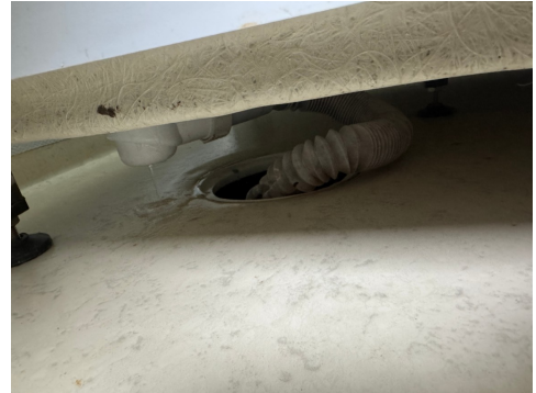
Lekkasje under dusjkabinett
