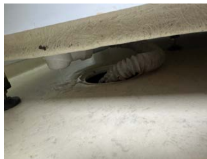
Lekkasje under dusjkabinett
