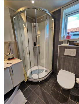
Dusjkabinett er ikke mulig å trekke frem for inspeksjon eller renhold av sluk.
