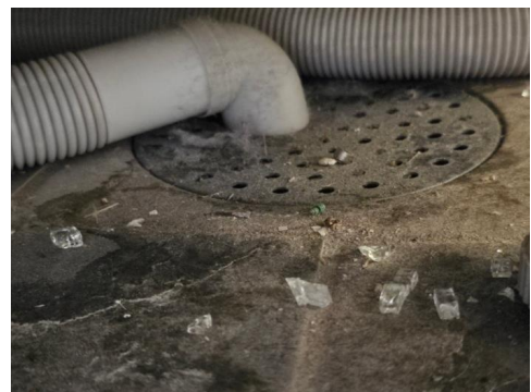
Sluk under kabinett. Lav høyde gjør inspeksjon av klemring vanskelig.
