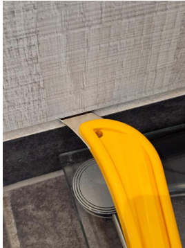
Manglende fuging mellom baderomsplater og sokkellist
