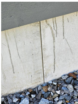
Manglende fuging av grunnmur
