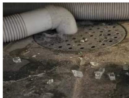
Sluk under kabinett. Lav høyde gjør inspeksjon av klemring vanskelig.
