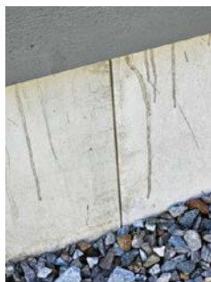
Manglende fuging av grunnmur
