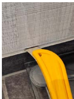
Manglende fuging mellom baderomsplater og sokkellist
