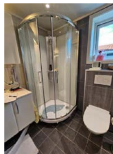
Dusjkabinett er ikke mulig å trekke frem for inspeksjon eller renhold av sluk.
