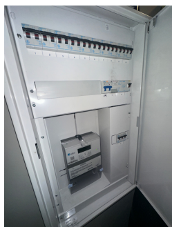
Sikringskap med automatsikringer.
