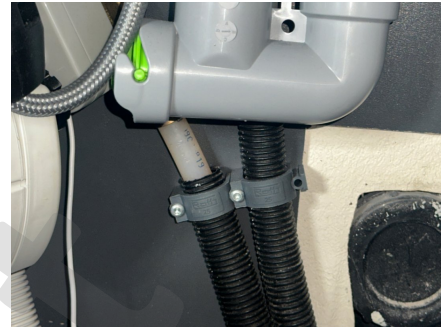
Manglende tettemuffe på vannrør.
