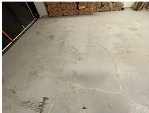
Sprekker i gulv.
