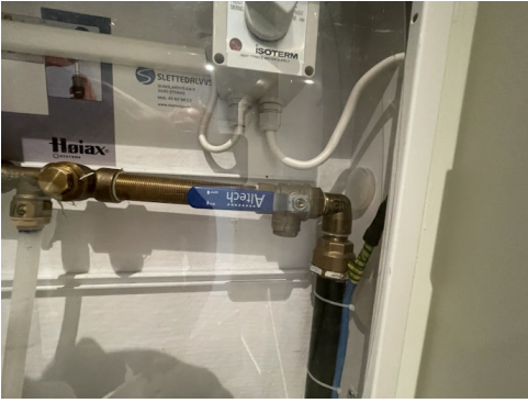
Stoppekran i rørfordelerskap.
