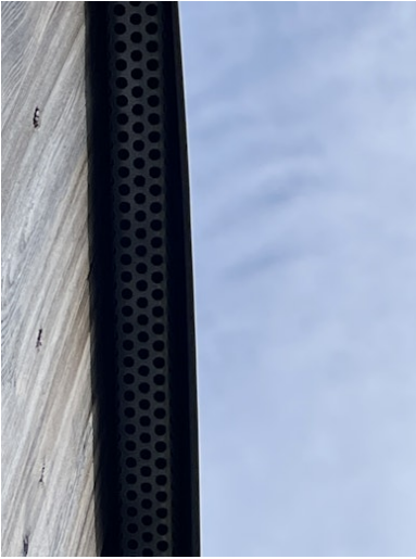
Lufteventil for lufting av takkonstruksjonen.
