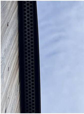
Lufteventil for lufting av takkonstruksjonen.
