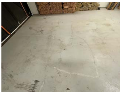
Sprekker i gulv.
