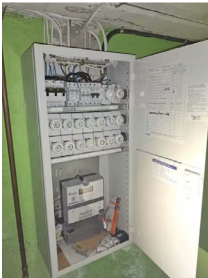
Sikringsskap er plassert i kjeller.
