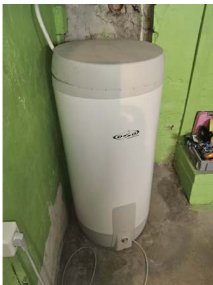
Varmtvannsbereder er plassert i kjeller.
