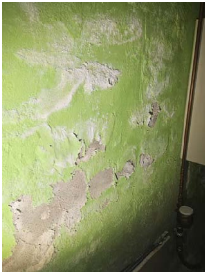
Det registreres salt/kalkutslag på kjellervegger.
