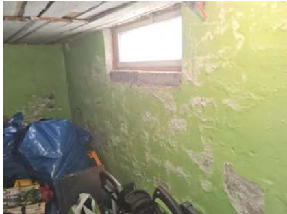
Det registreres salt/kalkutsalg på grunnmuren.
