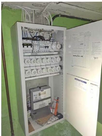
Sikringsskap er plassert i kjeller.
