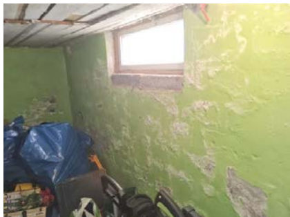
Det registreres salt/kalkutsalg på grunnmuren.
