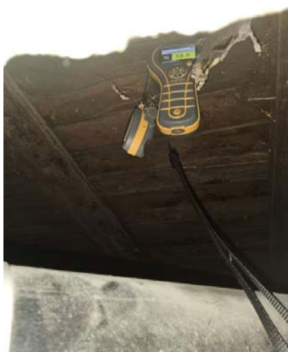
Det registreres forhøyet fuktverdi i overliggende etasjeskille.
