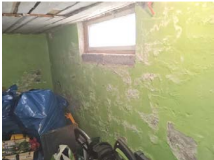
Det registreres salt/kalkutsalg på grunnmuren.
