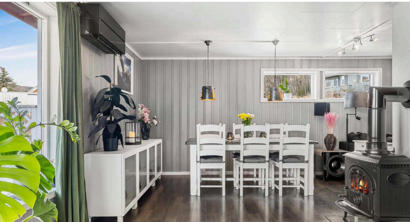
Stua har god plass til spisebord og er utstyrt med både varmepumpe og vedovn.
