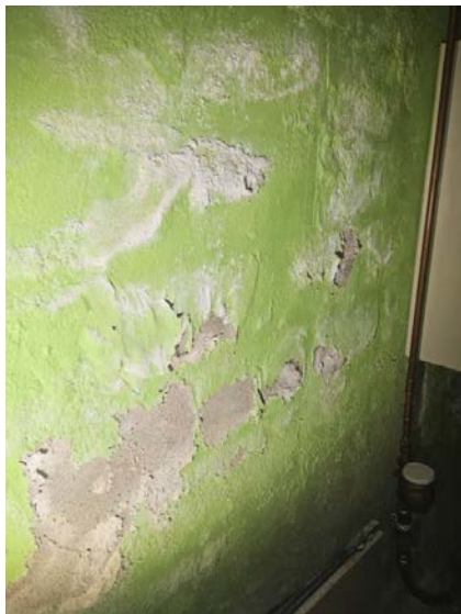
Det registreres salt/kalkutslag på kjellervegger.
