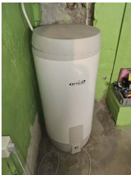
Varmtvannsbereder er plassert i kjeller.
