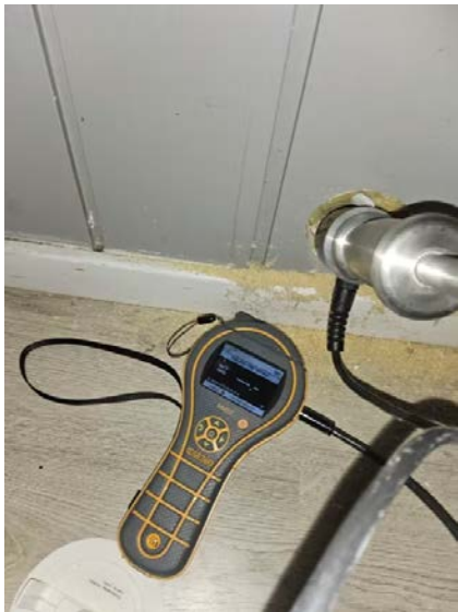
Bilde fra fuktmåling i tilstøtende veggkonstruksjon.
