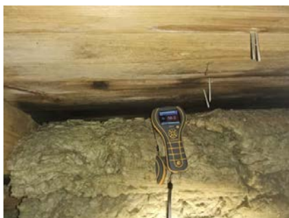
Det ble målt fibermetning i taktro i kott.
