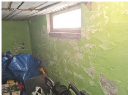
Det registreres salt/kalkutsalg på grunnmuren.
