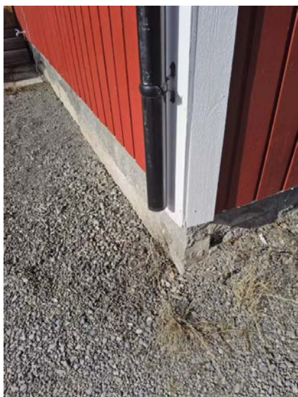
Nedløpsrør er avsluttet over terreng uten utast og bortledning fra grunnmuren.
