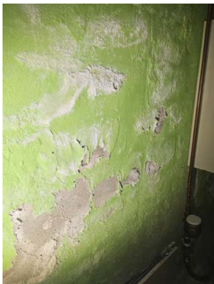
Det registreres salt/kalkutslag på kjellervegger.
