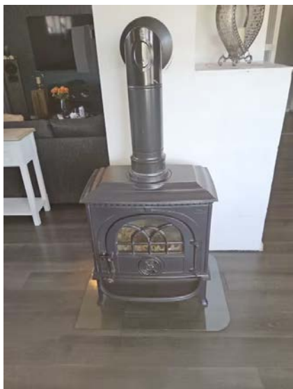
Vedovn i stue, ubrennbar plate er tilfredsstillende ikke minimumskrav.
