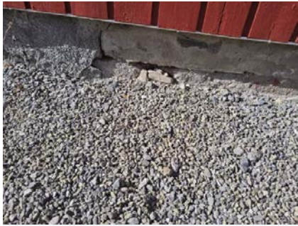
Det registreres pussavskaling på grunnmuren.
