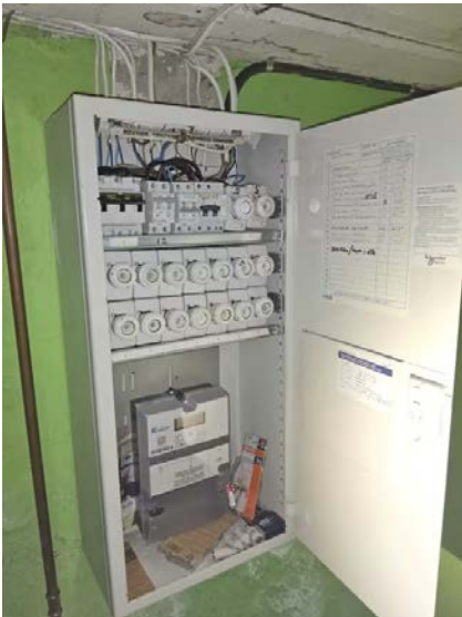
Sikringsskap er plassert i kjeller.
