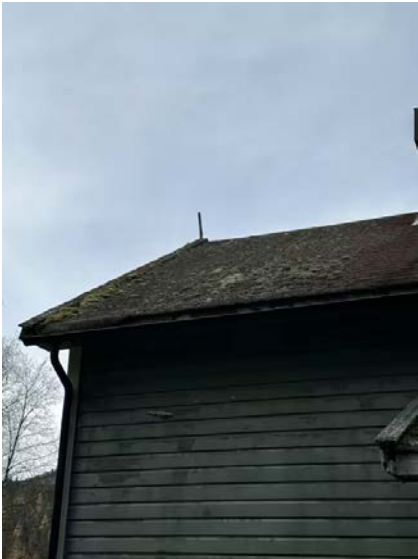
Takflater med generelt omfang av mosedannelse.
