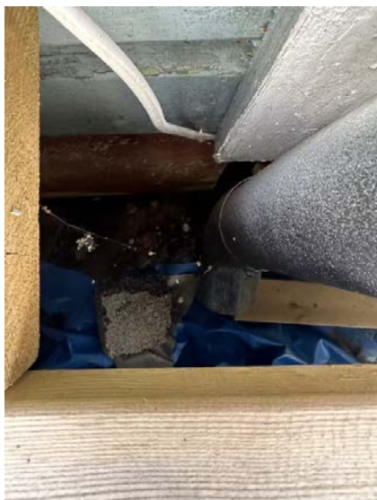
Nedløpsrør uten etablert drensrør under terrasse.
