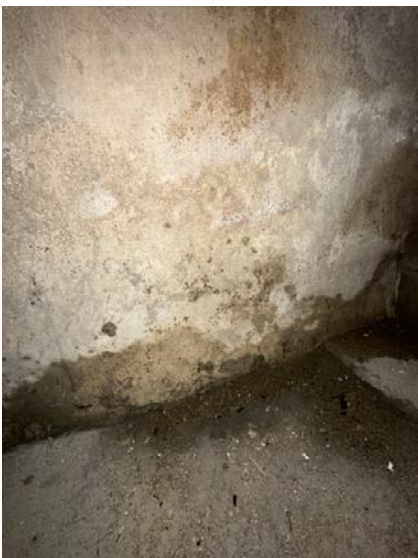
Viser fuktgjennomslag i grunnmur i kjeller.
