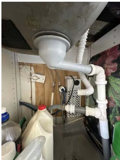
Overløp ikke tilknyttet avløp. Stikkontakt med noe ufagmessig utførelse.
