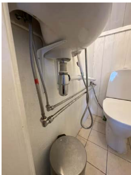
Rørstrekk på toalettrom er ikke betryggende festet.
