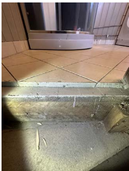
Viser manglende bruk/oppbrett av membran ved dør til kjeller.
