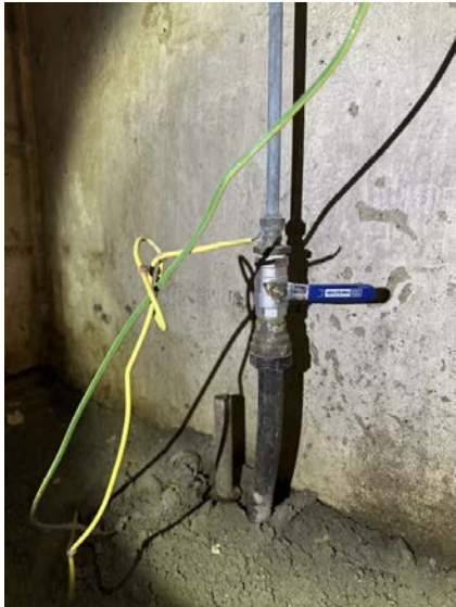
Viser manglende jording av vanninntak. Hovedstoppekran plassert i kjeller.
