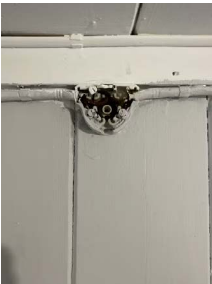
Eldre koblingssboks mangler lokk.
