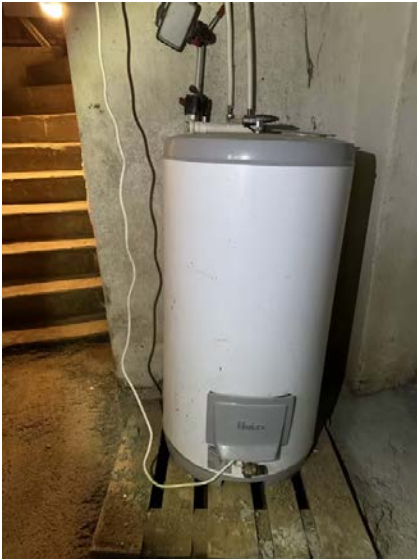
Viser Høiax bereder plassert på innstøpt Europall i kjeller.
