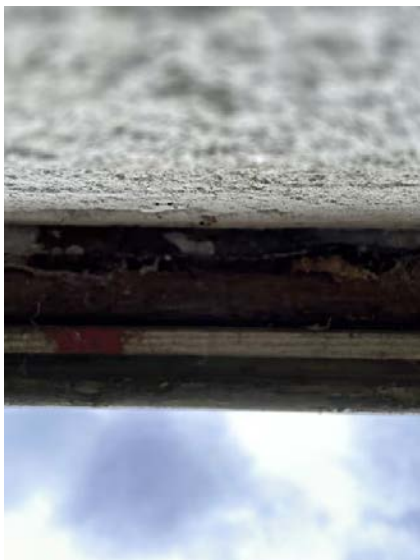
Kledningen er ikke luftet.
