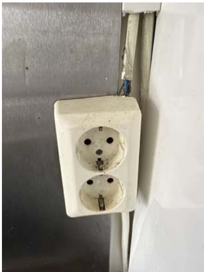
Viser stikkontakt med noe fagmessig utførelse.
