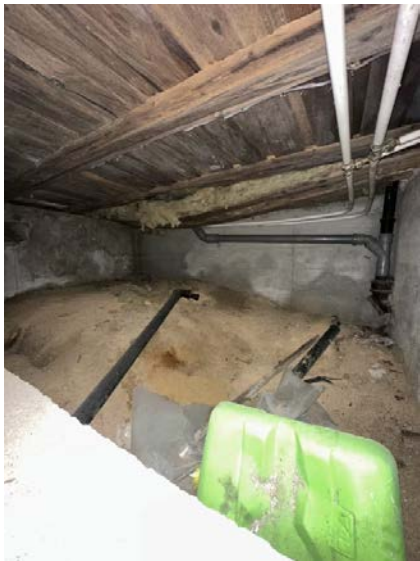
Deler av stubbloftkledningen og isolasjon i krypkjeller under baderommet har løsnet.
