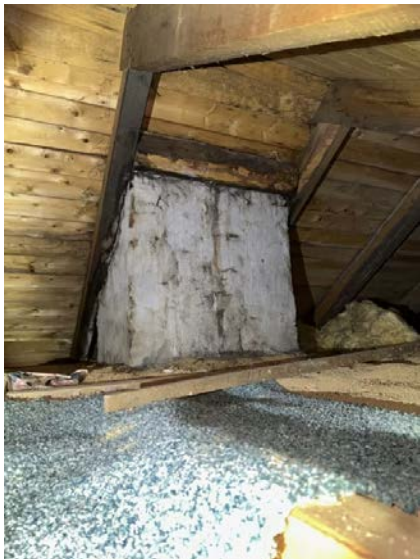
Viser loft. Loft med manglende adkomst. Bilde tatt fra gardintrapp.
