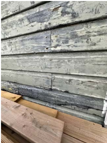
Det registreres missfarging/ svertesopp i overflater på fasader.
