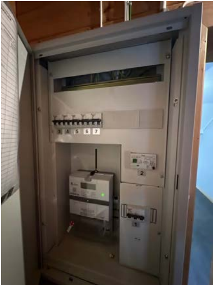
Viser sikringsskap plassert i bod 2.etasje
