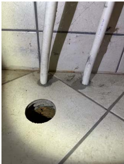
Viser hull i gulv på bad. Manglende bruk av membran/ mansjetter ved gjennomføringer.
