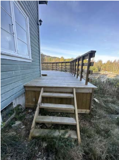
Det mangler rekkverk/håndløper for begge trapper.
