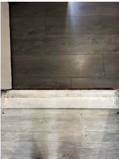
Overflater etablert med noe varierende håndverksmessig utførelse.
