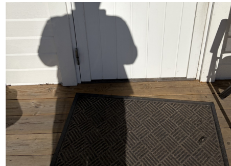
Mangler beslag mot vegg
