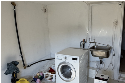
Avløp for vaskemaskin og skyllekar
