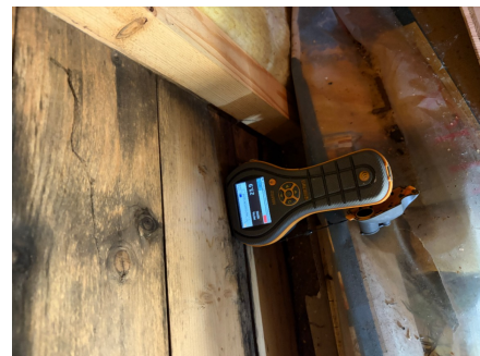
Fukt i kledning på gavel mot øst.
