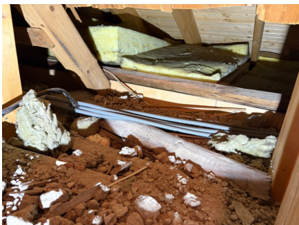
Mangelfull utført isolering
