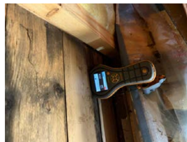
Fukt i kledning på gavel mot øst.
