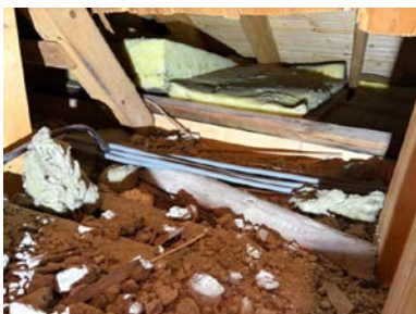
Mangelfull utført isolering
