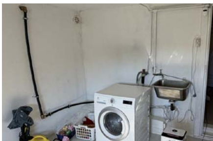
Avløp for vaskemaskin og skyllekar
