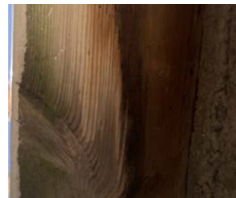
Ingen lufting i nedkant på vegg
