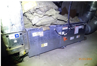
Ventilasjonsanlegg for restaurant (aggregat er monteret i kjeller).
