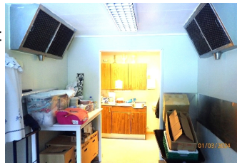
2 stk. avtrekkshetter av stål på kjøkken.
