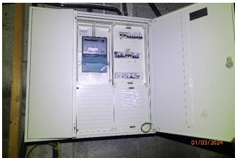
El. tavle i underetasje.
