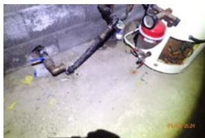
Innvendig stoppekran og frakoblet vannledning.
