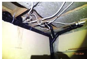
Åpne vannledninger av kobber i kjeller (fagmessig lite pent lagt).
