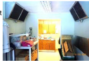
2 stk. avtrekkshefter av stål på kjøkken.
