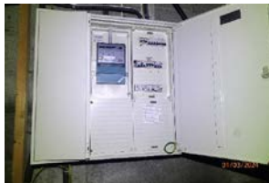
El. tavle i underetasje.
