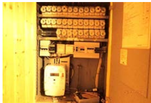
El. skap i underetasje.
