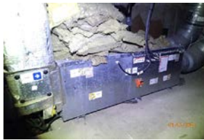
Ventilasjonsanlegg for restaurant (aggregat er montert i kjeller).
