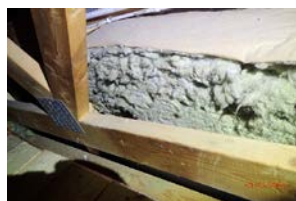
Synlige merker på isolasjon etter mus.
