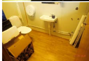
Felles toalett i romgang 1. etasje.
