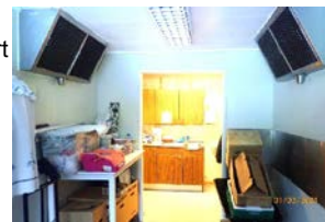
2 stk. avtrekkssetter av stål på kjøkken.
