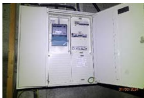
El. tavle i underetasje.
