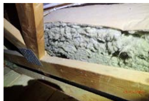
Synlige merker på isolasjon etter mus.
