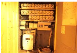
El. skap i underetasje.
