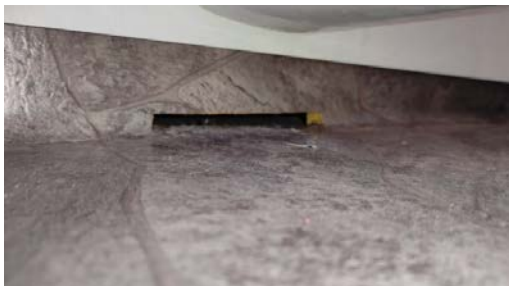
Drensåpning fra innebygd siste.
