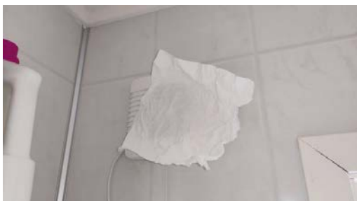
Test av avtrekket.
