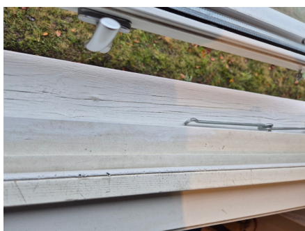
Noe slitt treverk og pakningslist på soverom.
