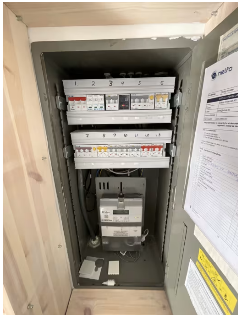
Viser sikringskap plassert i 2.etasje.
