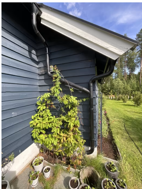
Det anbefales å snu utkast ved nedløpsrør og etablere drensør på utkast.
