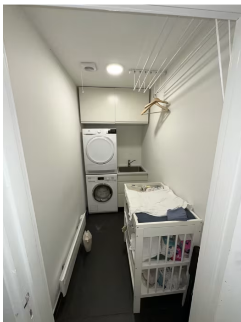
Viser installasjoner på vaskerom.
