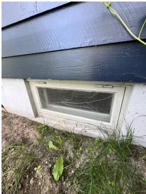
Viser sprekk i glass ved kjellervindu.
