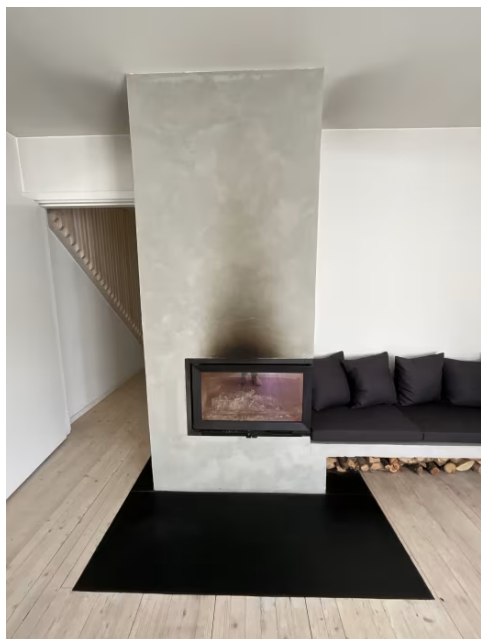
Viser ildsted plassert i stue 1.etasje
