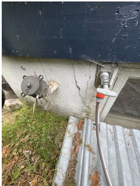
Viser sprekk i grunnmur.
