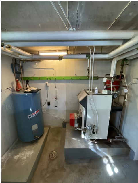
Viser oljefyr og varmtvannsbereider plassert i fyrrom.
