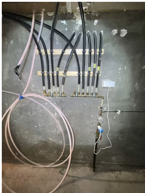
Viser vanninntak, hovedstoppekran og vannmåler i kjeller.
