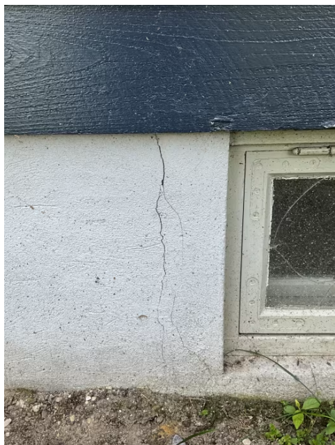
Viser sprekk i grunnmur.
