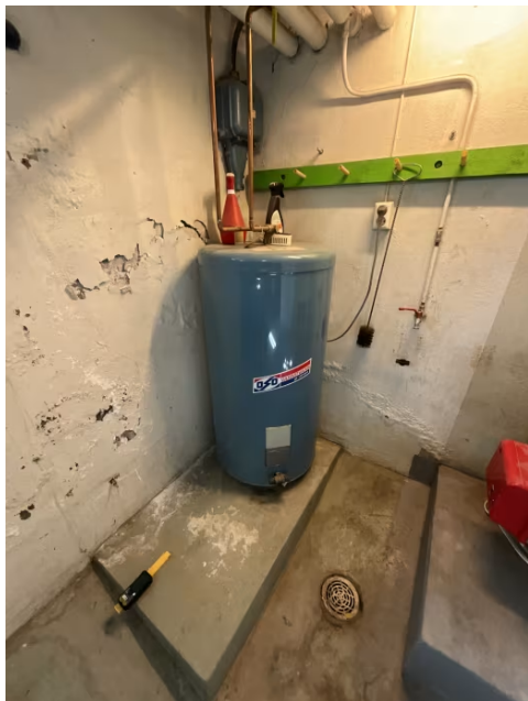
Viser varmtvannsbereder plassert i fyrrom.
