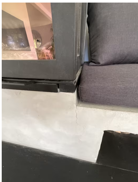
Viser mindre sprekk i overgang mot benk.
