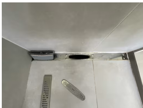
Viser sluk i dusjsonen.
