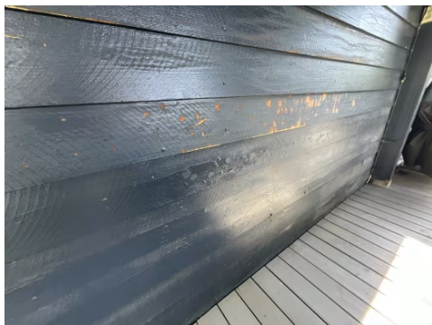
Det registreres blærer i overflatebehandling/malingen. Skyldes trolig tidligere behandling med linolje.
