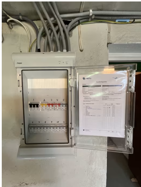
Viser sikringskap plassert i fyrrom i kjeller.
