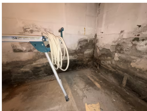
Det registreres mineralutslag (salt/kalkutsalg/mugg) i overflater som er et symptom på fuktvandring gjennom grunnmur.
