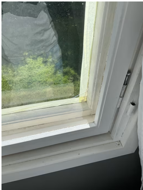
Viser sprekk i glass ved soveromsvindu.
