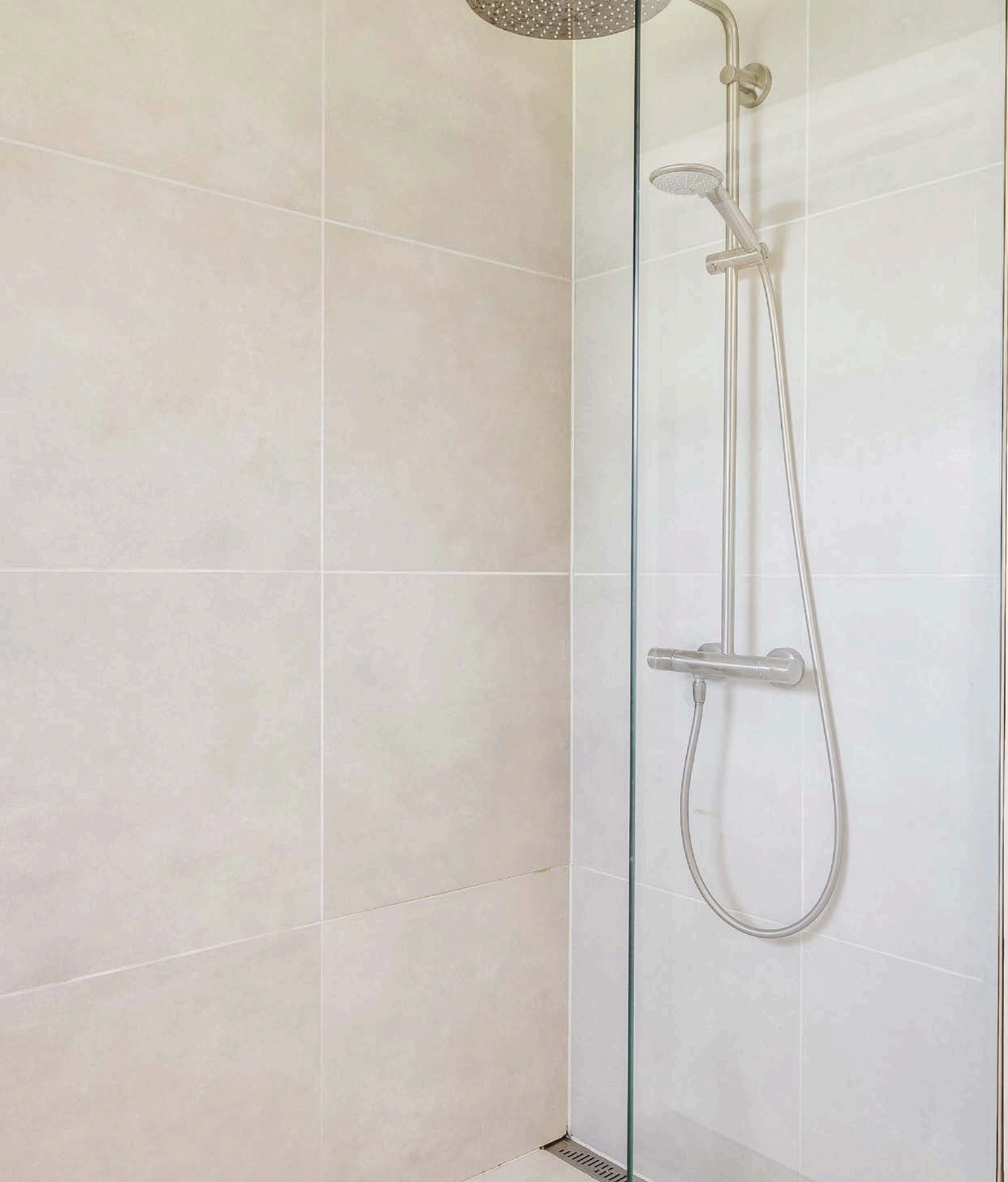
Dusjnisen med både regnfalldusj og dusjhode. Merk også den lekre løsningen med sluklisten mot vegg på gulv.
