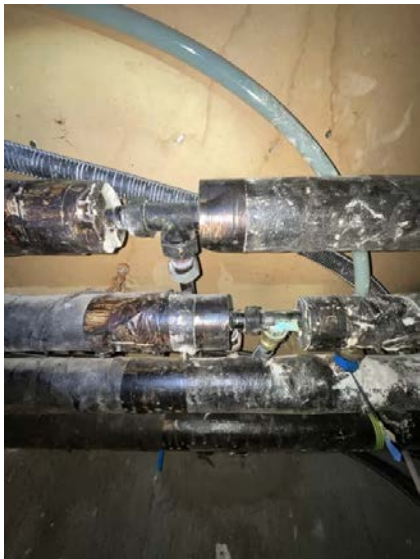
Det registreres irr og mindre drypplekkasjer på rør i kjeller.
