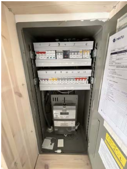
Viser sikringsskap plassert i 2.etasje.
