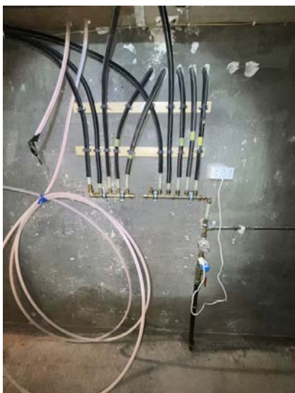
Viser vanninntak, hovedstoppekran og vannmåler i kjeller.
