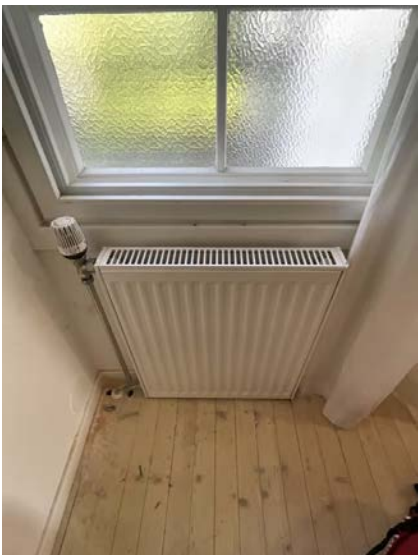
Det er etablert en nyere radiator i gang.
