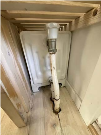
Det registreres stedvis irr og rust på koblinger.
