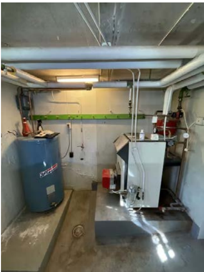
Viser oljefyr og varmtvannsbereider plassert i fyrrom.
