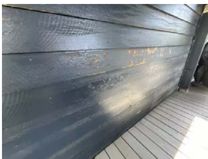
Det registreres blærer i overflatebehandling/malingen. Skyldes trolig tidligere behandling med linolje.
