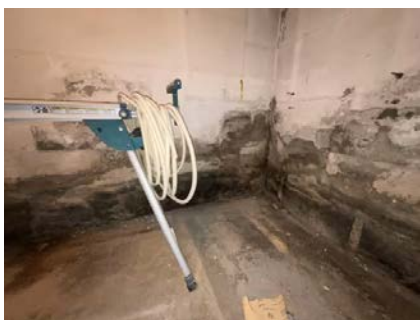
Det registreres mineralutslag (salt/kalkutsalg/mugg) i overflater som er et symptom på fuktvandring gjennom grunnmur.
