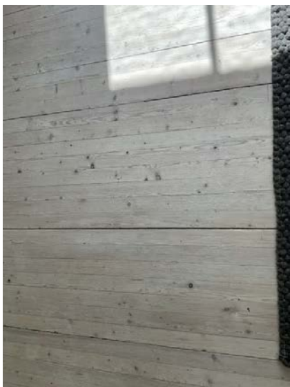
Det registreres sprekker i tregulv.
