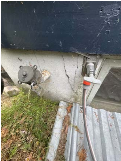
Viser sprekk i grunnmur.
