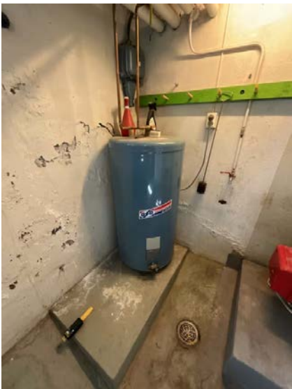
Viser varmtvannsbereder plassert i fyrrom.
