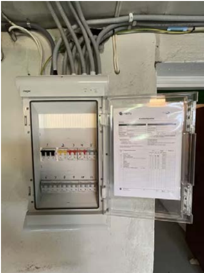
Viser sikringsskap plassert i fyrrom i kjeller.
