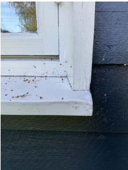
Det er påvist avvik ved omramming. Liten/ingen avstand mellom trepanel og beslag, fare for fuktopptrekk.
