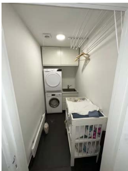
Viser installasjoner på vaskerom.
