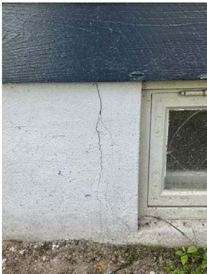
Viser sprekk i grunnmur.
