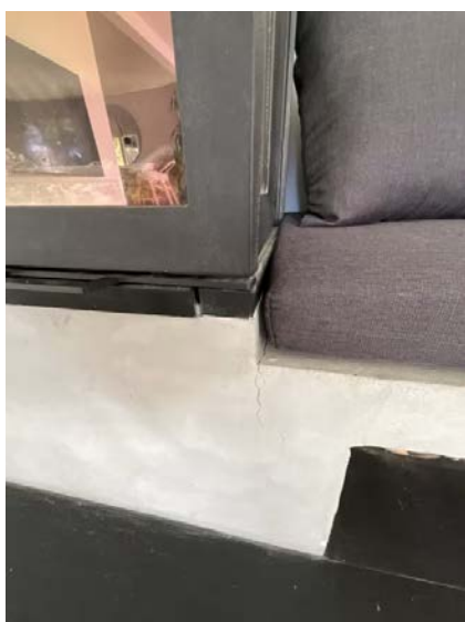
Viser mindre sprekk i overgang mot benk.
