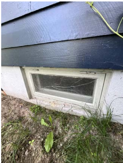
Viser sprekk i glass ved kjellervindu.
