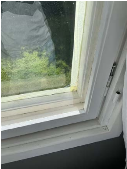
Viser sprekk i glass ved soveromsvindu.
