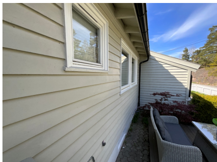
Liten skade ved døra.
