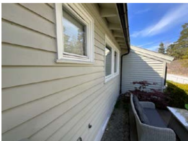
Liten skade ved døra.
