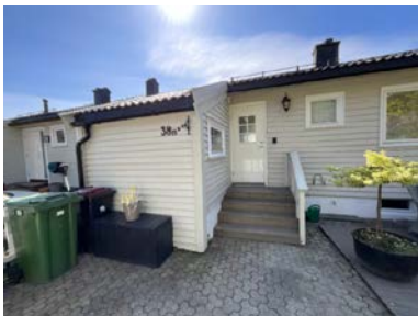
Mangler snøfanger på deler av taket.
