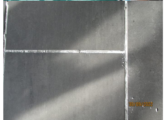
Saltutslag i fuger
