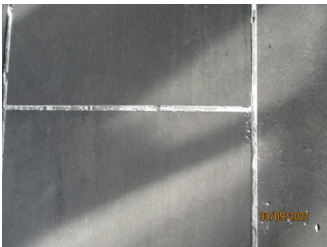
Saltutslag i fuger
