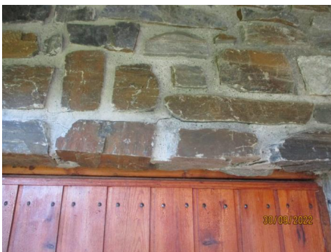
Riss/sprekk over dør til teknisk rom i kjeller
