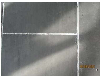
Saltutslag i fuger
