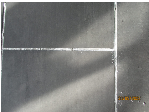
Saltutslag i fuger
