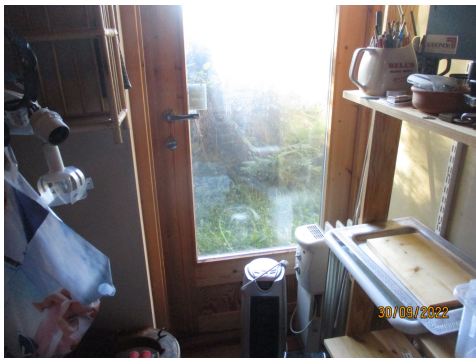
Punktert vindu i dør, kjeller
