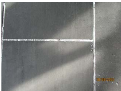
Saltutslag i fuger
