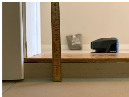
Oppkant under dør 35mm
