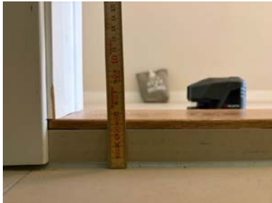
Oppkant under dør 35mm
