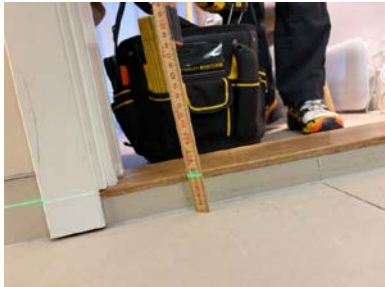
Oppkant under dør til soverom 35mm
