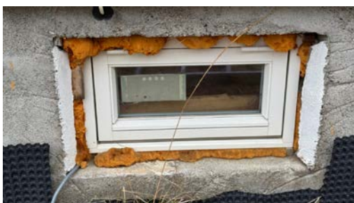
Det er påvist avvik rundt innsettsdetaljer.
