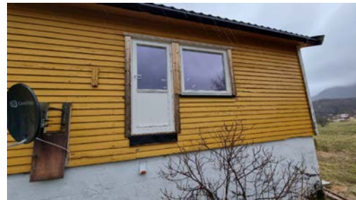
Det mangler trapp/terrasse.
