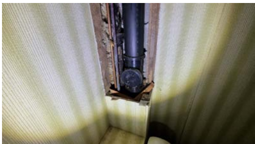
Avløpsrør av plast.
