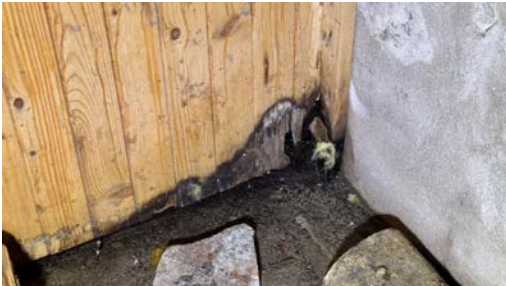
Det er påvist synlige fukt/råteskader i treverk i kjeller.
