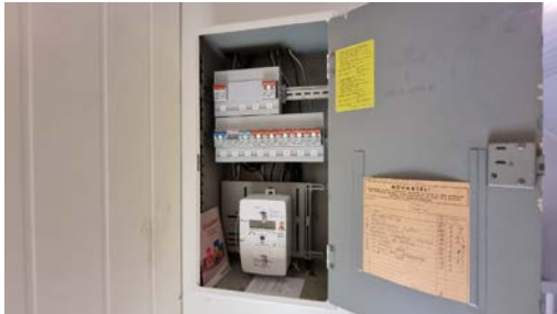
Kontroll av el-skap og kursfortegnelse.
