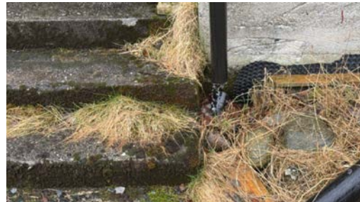
Vann blir ikke tilfredsstillende ledet bort fra bygningskroppen.
