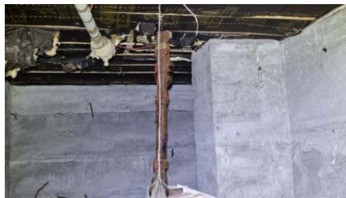
Avløpsrør av soil.
