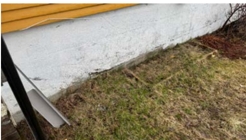
Manglende utvendig fuktsikring.
