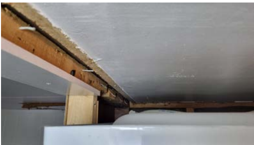
Vegg bak dusjkabinett mangler tettesjikt (veggplater)
