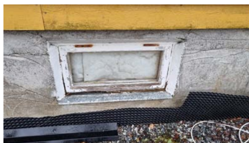
Vindu har råteskade.
