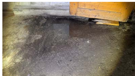
Det er registrert vann på kjellergulv.
