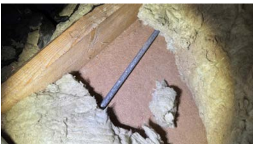
Manglende dampsperre i takkonstruksjonen.
