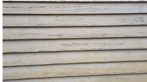
Det er værslitt/oppsprukket trevirke/trepener.
