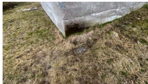
Manglende utvendig fuktsikring.
