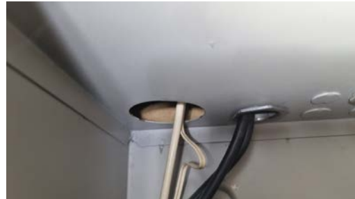
Kabelgjennomføringer er ikke tilfredsstillende tettet.
