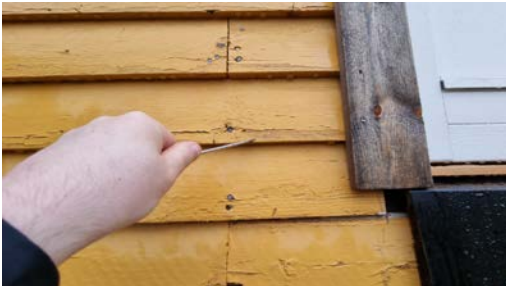
Det er påvist spredte råteskader i bordkledningen.
