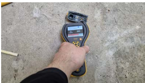
Det ble registrert forhøyde fuktverdier i gulv.
