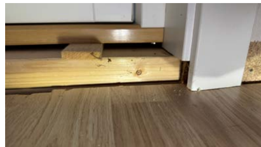
Det er utettheter under dørterskel for balkongdør.
