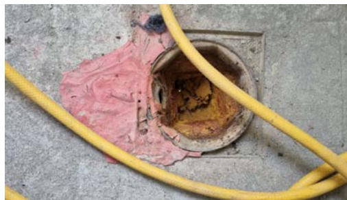
Soilsluk fra byggeår.
