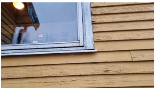
Vindu har værslitasje.
