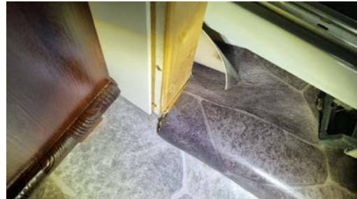
Ufagmessig utførelse av overgang mellom belegg.
