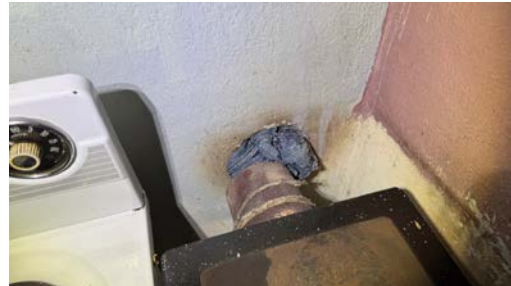
Røykrør er ikke tilfredsstillende tettet.
