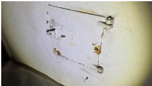
Det er registrert noe rust i sotluke.
