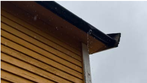
Det mangler takrennenedløp.
