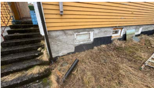
Utvendig fuktsikring er ufagmessig montert og mangler klemlist.
