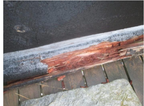
Råteskader på en bunnstokk til rekkverk.
