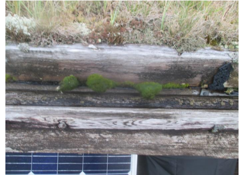
Noe slitt bunnstokk med tilhørende innfestning.
