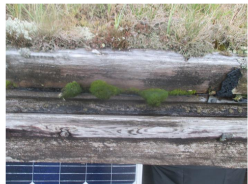
Takrenner av tre er slitt/skadet.
