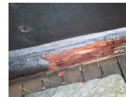
Råteskader på en bunnstokk til rekkverk.
