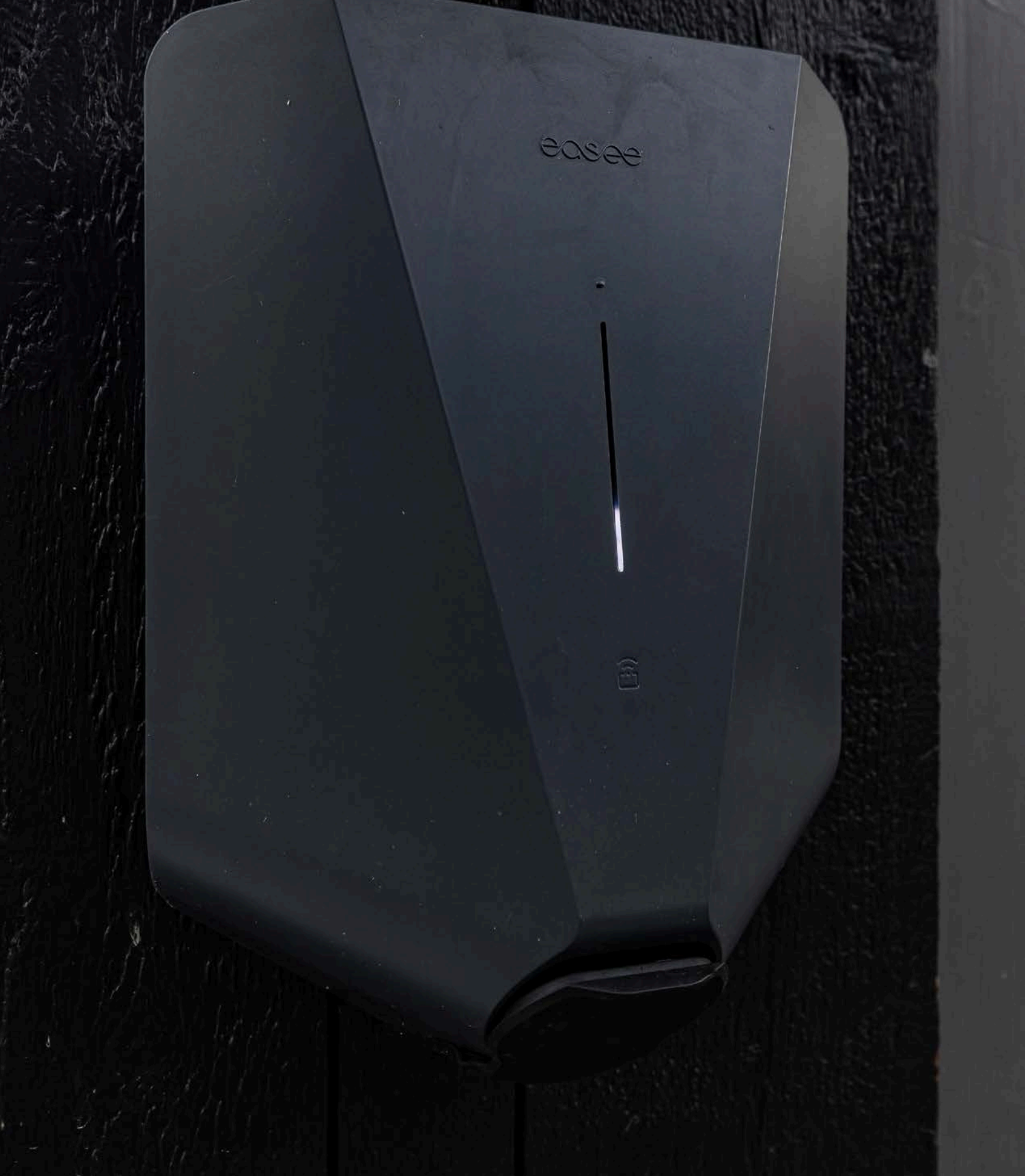
Ladeboks fra Easee er montert på vegg på uteboden.
