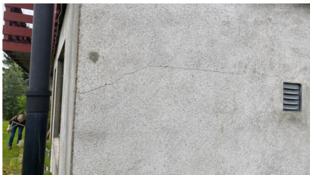
Stedvis sprekker/riss i puss.
