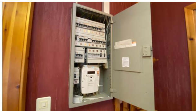
Kontroll av el-skapet.
