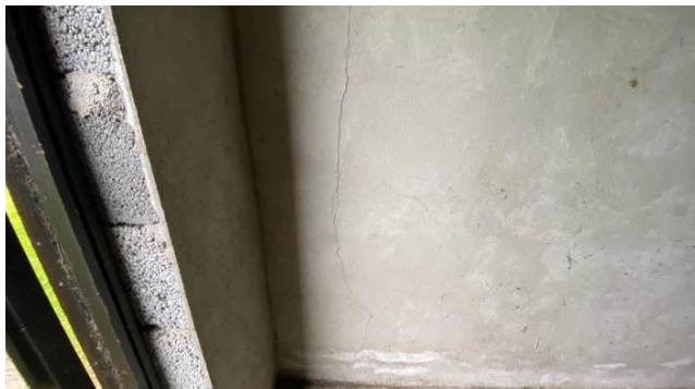
Stedvis sprekker/riss i puss.
