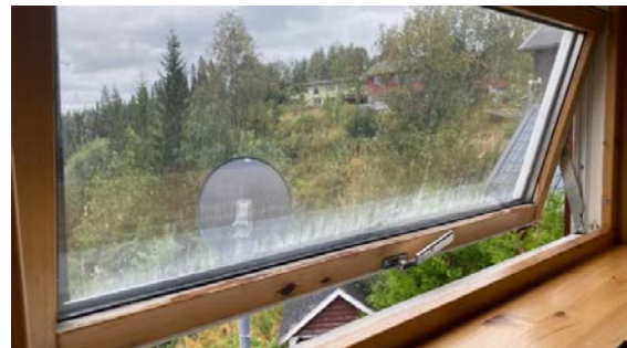
To punkterte vinduer i loftsetasjen.
