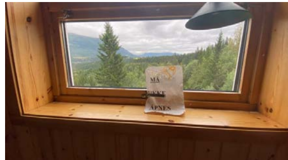
Ett vindu i loftsetasjen er provisorisk festet (kan ikke åpnes og lukkes).
