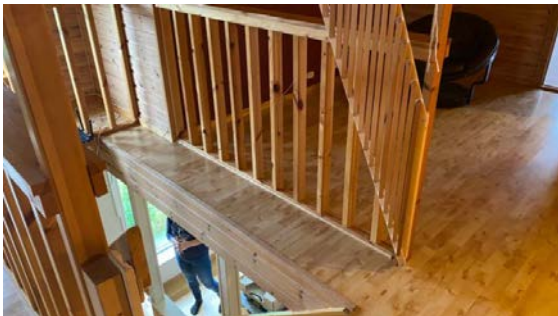
Det er mulig å gå på "utsiden" av det ene rekkverket i loftsetasjen.
