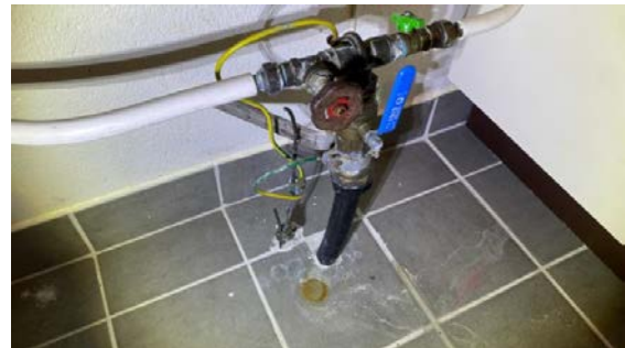
Kontroll av innvendig hovedstoppekran.
