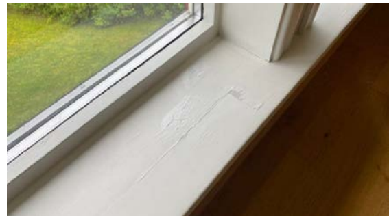
Malingsavflassing i utforing på stuen.
