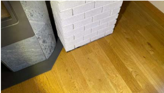
Manglende avslutning mellom parkett og pipe, samt mellom parkett og trapp.
