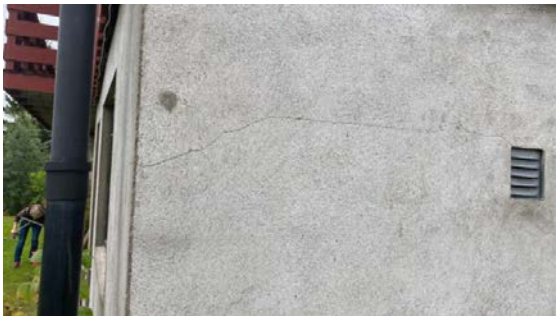
Stedvis sprekker/riss i puss.
