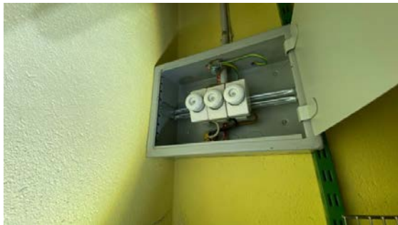
Inntakssiringer montert i sokkeletasjen.
