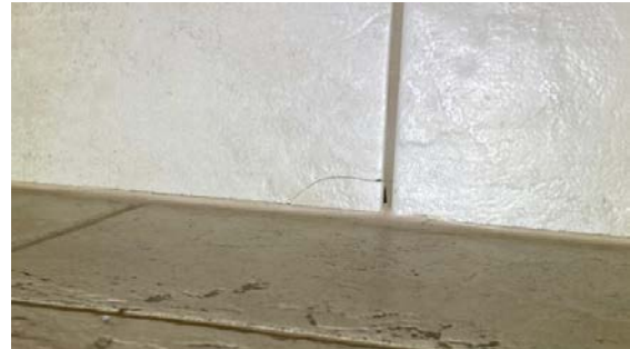
Sprekk i flis under innredningen.
