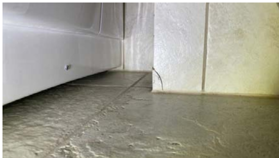
Sprekk i flis på sisternekassen.
