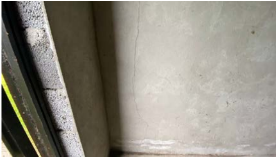
Stedvis sprekker/riss i puss.
