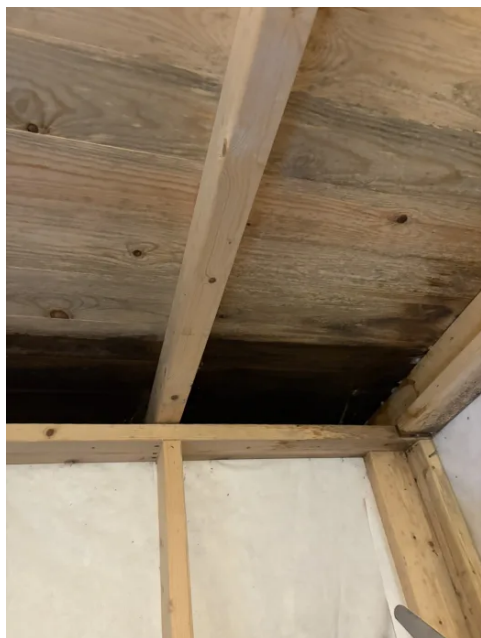
Lekkasje i tak.
