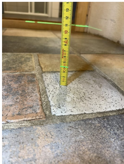
Avvik på gulv.
