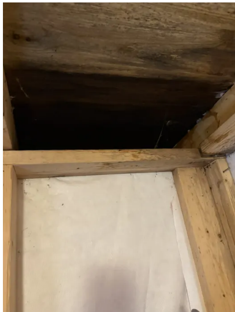
Lekkasje i tak.
