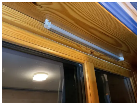
Ventil i vindu.
