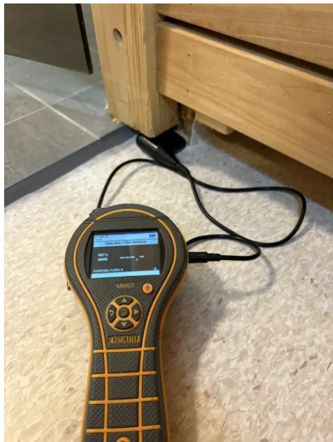
Fuktmåling i svill.
