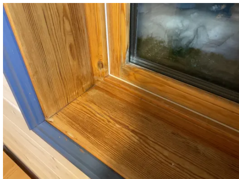
Fuktmerker i vinduer.
