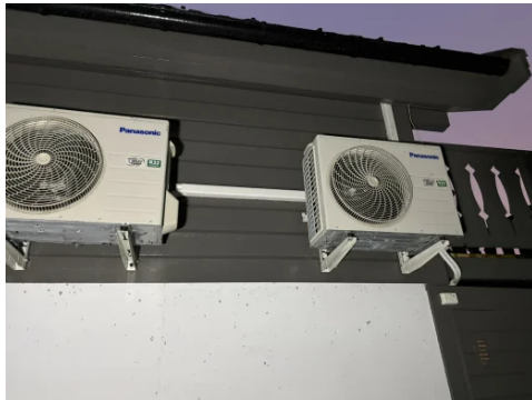
Utvendig del av varmpumpe.
