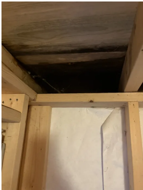
Lekkasje i tak.
