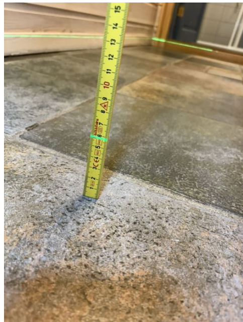
Avvik på gulv.
