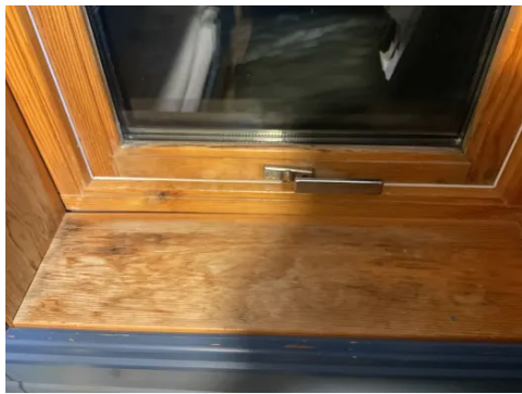
Fuktmerker i vinduer.
