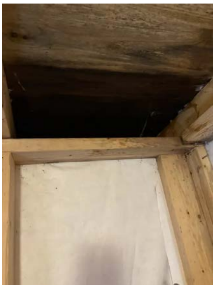
Lekkasje i tak.
