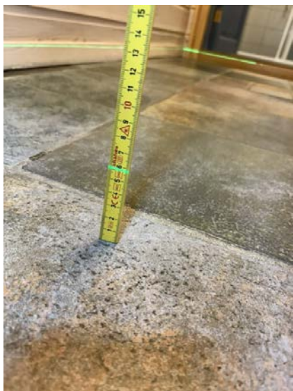
Avvik på gulv.
