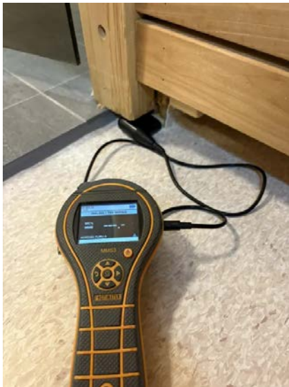
Fuktmåling i svill.
