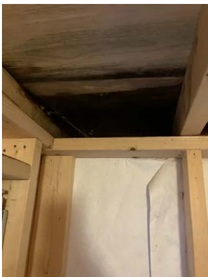
Lekkasje i tak.
