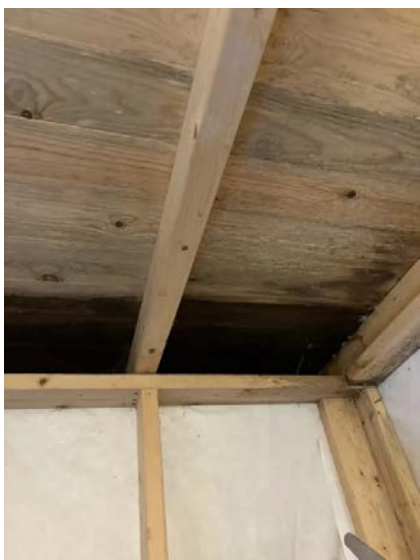
Lekkasje i tak.
