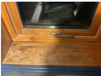
Fuktmerker i vinduer.
