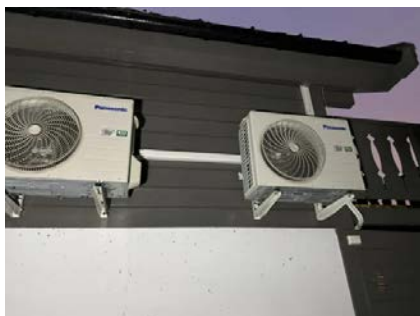
Utvendig del av varmepumpe.
