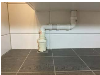
Avløpsrør på bad.
