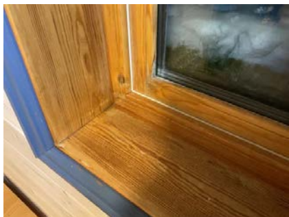
Fuktmerker i vinduer.
