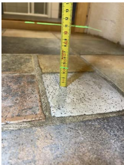
Avvik på gulv.
