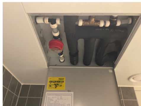
Rør i rør skap i taket
