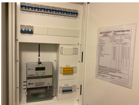
Sikringskap i teknisk rom
