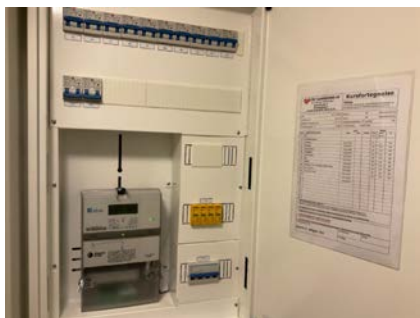
Sikringsskap i teknisk rom
