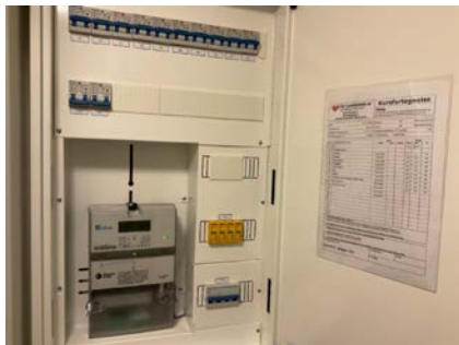
Sikringsskap i teknisk rom
