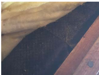
Svartpapp mellom himling og isolasjon.
