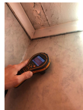
Bildet viser himling og fuktsøk i dusjsonen.
