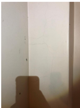
Bilde av sprekker/riss på pipen 1 etasje
