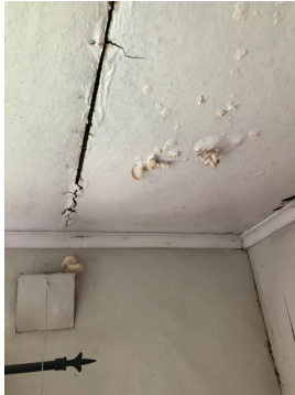
Bilde av taklekkasje på soverom i 1 etasje.
