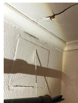
Bilde av skade i himling på soverom i underetasje.
