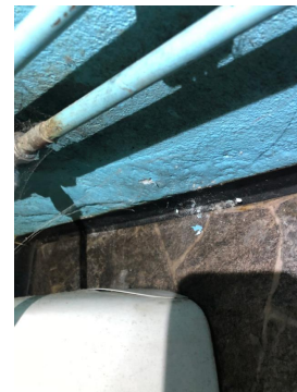
Bilde av vegg mot terreng fra wc rom.
