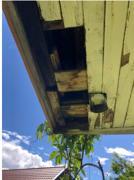
Bilde av råteskader under balkongen
