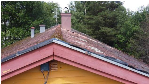
Avflakking av overflatebehandling på israftbeslag.
