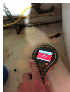
Bildet viser indikasjon på fukt i underskap.
