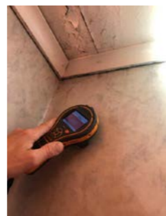
Bildet viser himling og fuktsøk i dusjonen.
