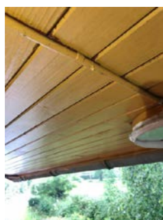
Bildet viser vanndråper fra himling utenfor inngangsparti
