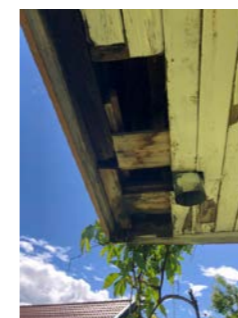
Bilde av råteskader under balkongen
