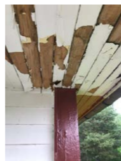
Bilde av taklekkasje ved balkong.
