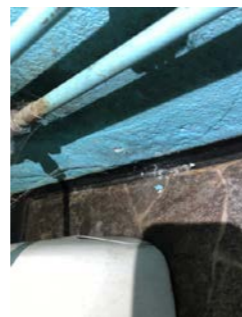
Bilde av vegg mot terreng fra wc rom.
