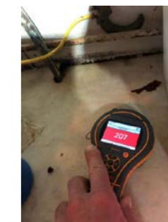
Bildet viser indikasjon på fukt i underskap.
