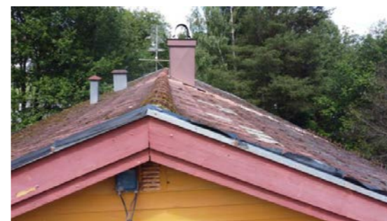
Avflakking av overflatebehandling på israftbeslag.
