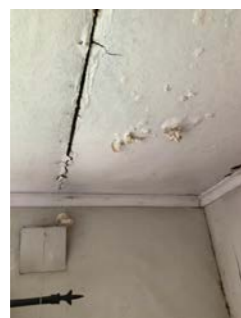
Bilde av taklekkasje på soverom i 1 etasje.
