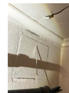
Bilde av skade i himling på soverom i underetasje.
