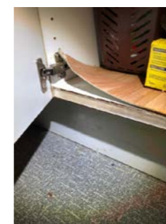
Bilde av svelling i kjøkkenskap
