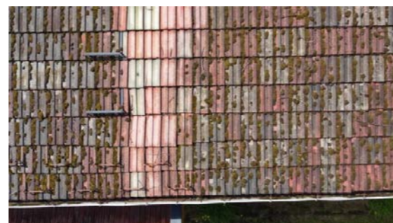
Bilde av takstein over balkong
