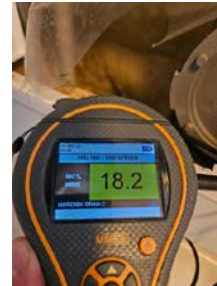
Måling av trefukt i utlektet vegg under terreng.
