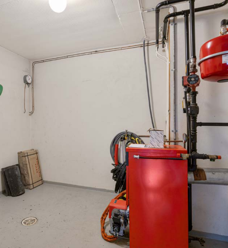
Boligen har lagringsplass på loft og i inneboder. Bildet viser fyrrommet.
