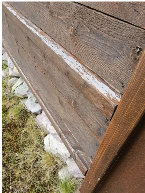
Bilde viser værslitt kledning.
