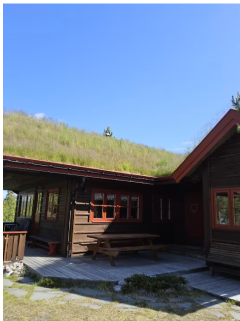
Bilde viser manglende snøfangere.
