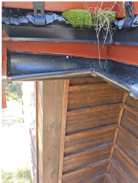
Bilde viser vridd takrenne.
