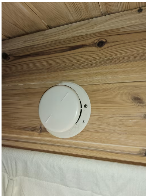
Bilde viser friskluftsventil.
