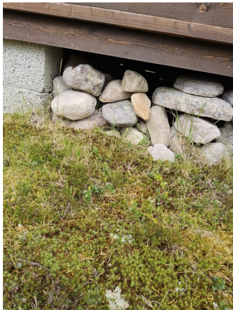
Bilde viser begrenset tilkomst til kryprom.
