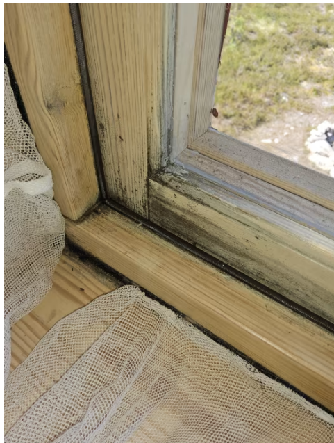
Bilde viser fuktpåvirket vindu.
