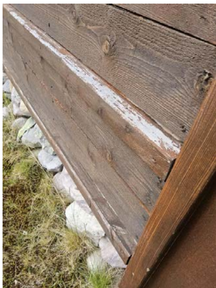
Bilde viser værslitt kledning.
