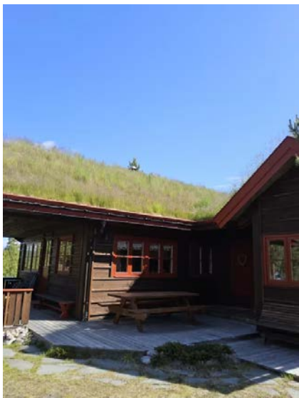
Bilde viser manglende snøfanger.
