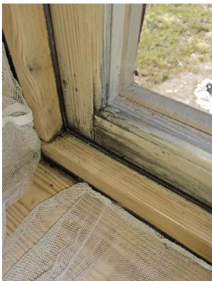
Bilde viser fuktpåvirket vindu.
