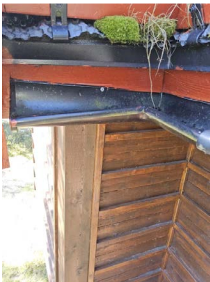
Bilde viser vridd takrenne.
