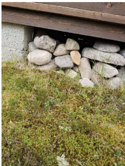
Bilde viser begrenset tilkomst til kryprom.
